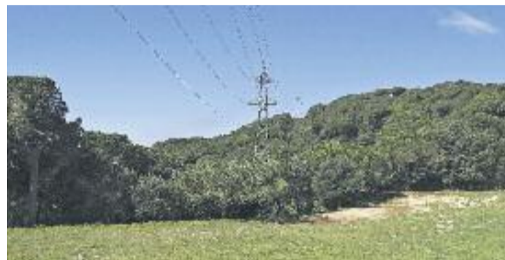
Línia elèctrica al seu pas per Sant Fost. Foto: Endesa
