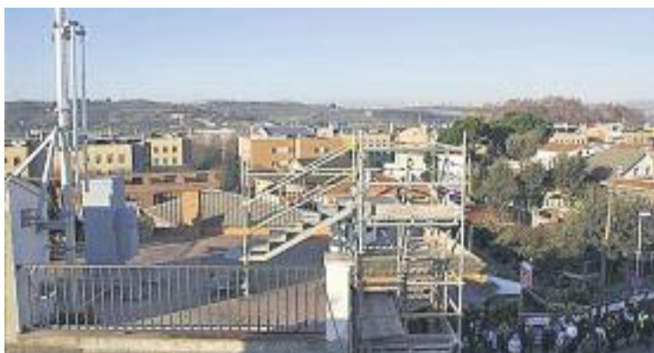
Des de divendres passat les obres de l'antena estan aturades. Foto: Ajuntament
