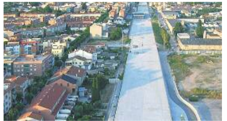
Zona de llosa que cobreix el túnel de soterrament. Foto: Ajuntament Montmeló
