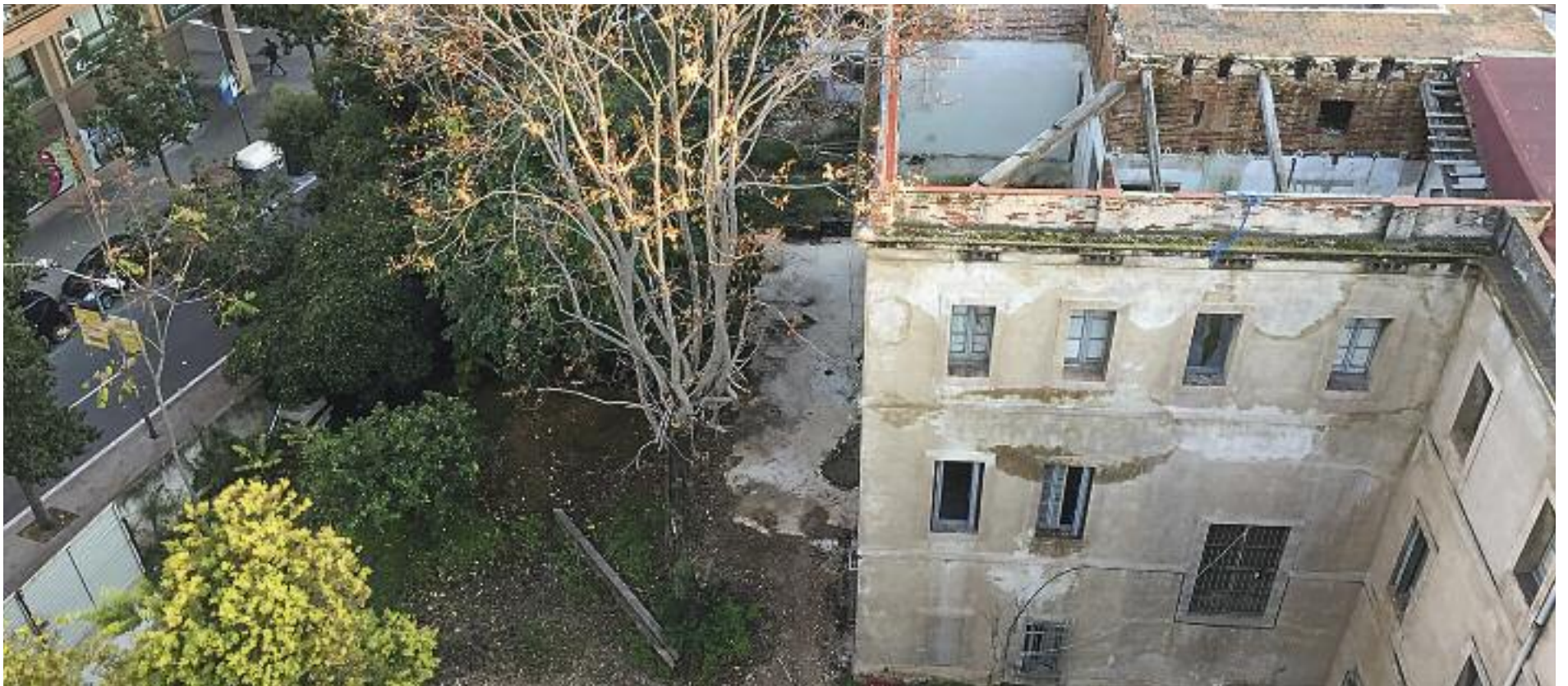
Els veïns denuncien que l'edifici està en molt mal estat. Foto cedida
