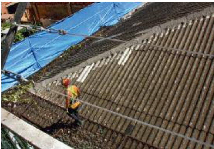
L'amiant es concentra, sobretot, en les cobertes industrials. Foto: ACN
