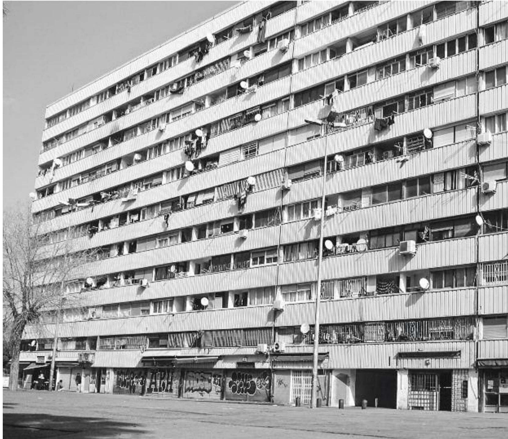
El bloc Venus, situat a la Mina de Sant Adrià de Besòs, és l'exemple més clar d'edifici en estat de degradació a la metròpoli. Foto: Albert Alexandre
