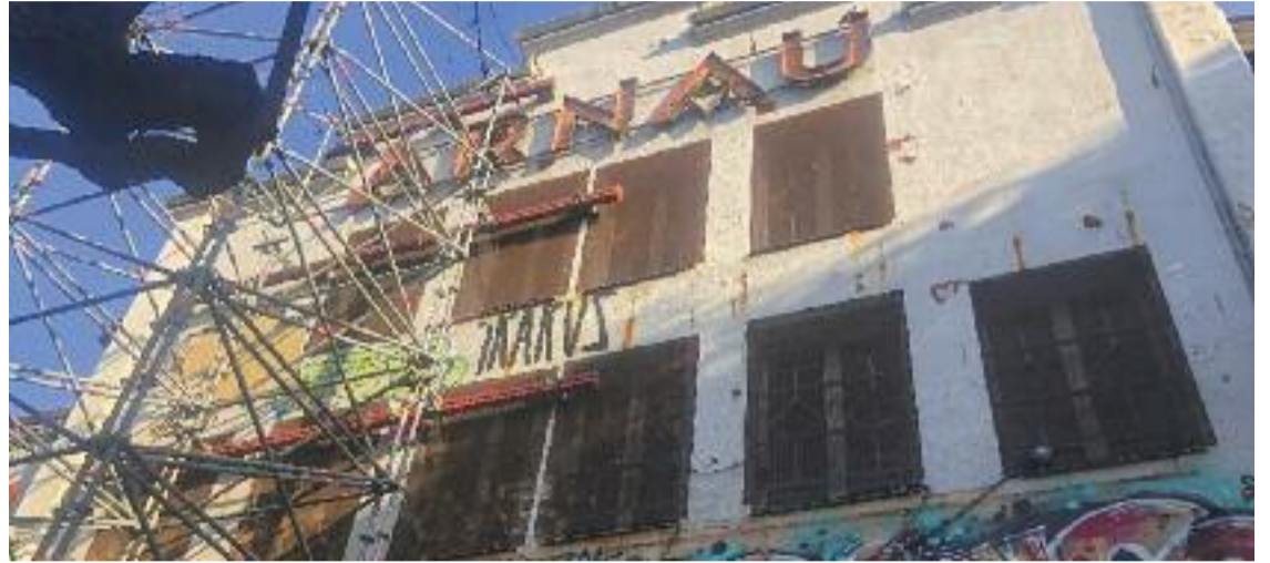
L'edifici està molt deteriorat des de fa temps. Foto: Línia Sants
