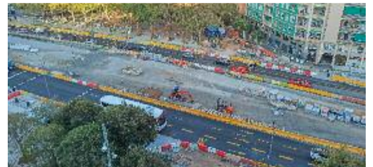
El tram d'obres entre Felip II i la Meridiana. Foto: Twitter (@meridianaobres)
