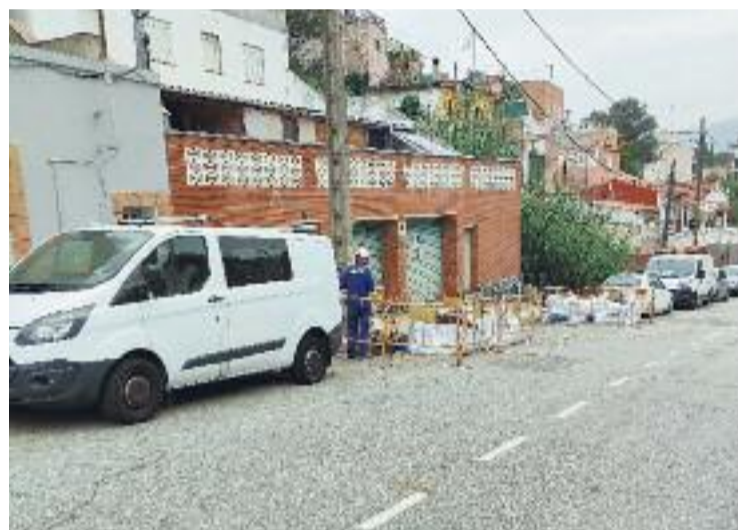
Moment de la reparació de la línia de llum. Foto: Twitter (@TorreBaroAVV)
