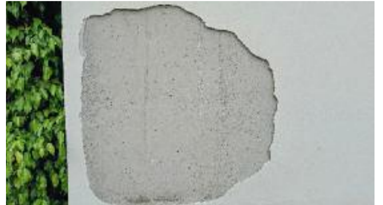
Un dels desperfectes del teatre. Foto: Ajuntament
