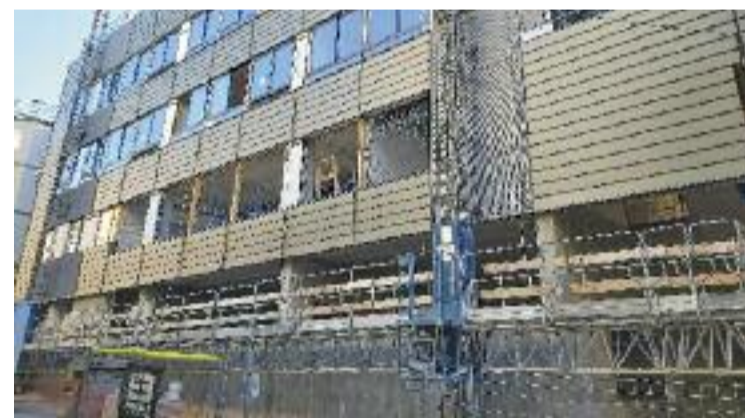
Estat actual de les obres del nou edifici de l'escola. Foto: Línia LH
