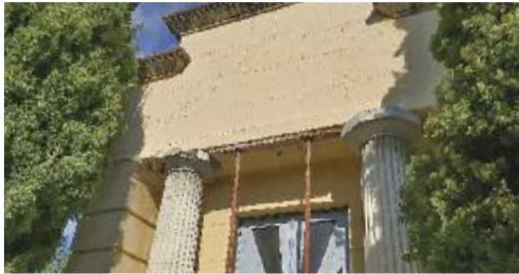
L'edifici està actualment apuntalat. Foto: Línia LH
