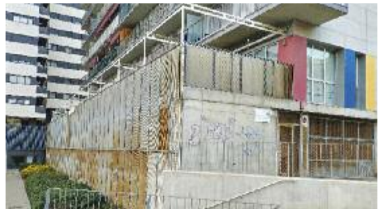
Diferents parts de l'edifici s'estan degradant. Foto: Línia L'H
