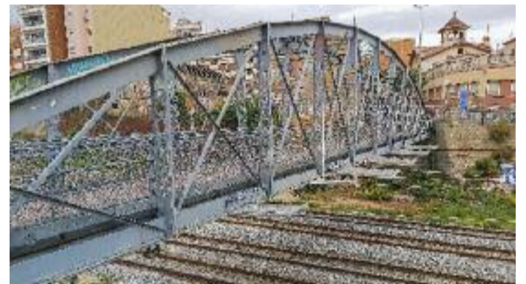
El pont té diverses parts deteriorades. Foto: Arxiu
