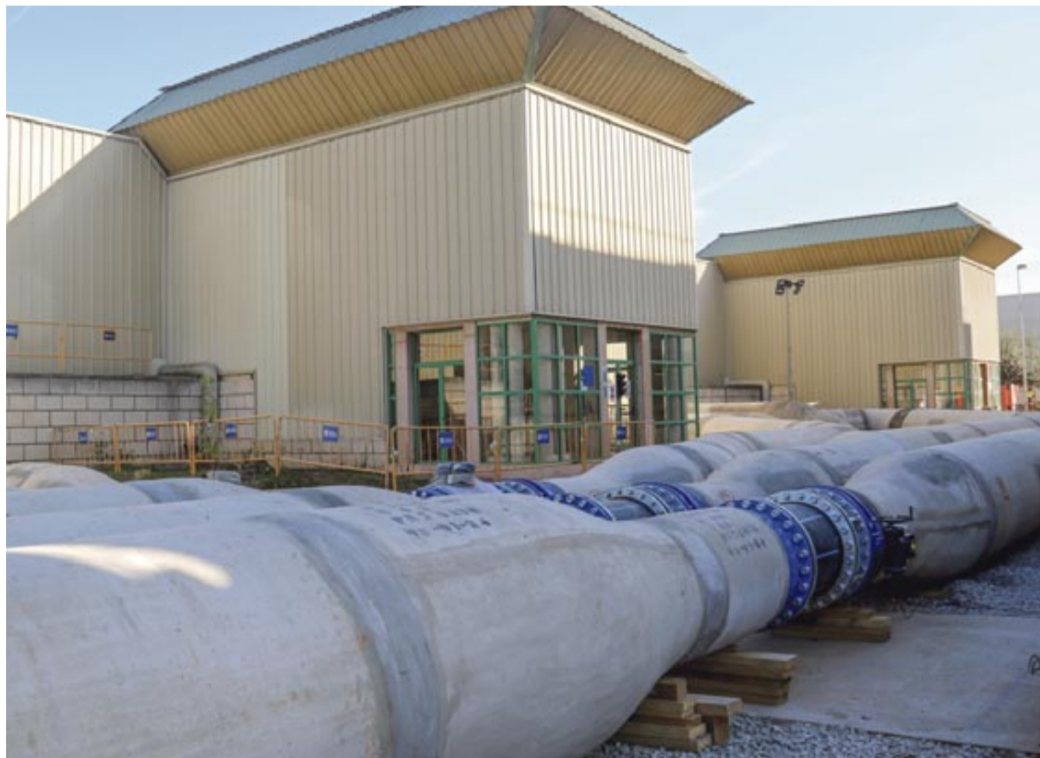
Les noves canonades que capten l'aigua subterrània a Sant Joan Despí. Foto: Àlex Recolons/ACN
