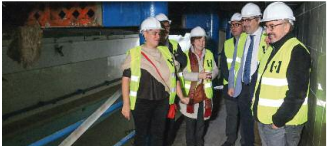
Les entitats constructores, Ajuntament i el Sant Pau han visitat les obres. Foto: Marta Vidal i Maria Pradesaba/ACN
