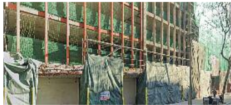
El problemàtic edifici en obres del carrer Sardanya. Foto: Google Maps
