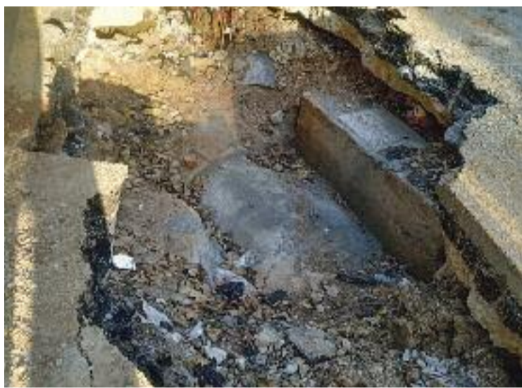
Una canonada apareguda durant la primera fase de les obres. Foto cedida
