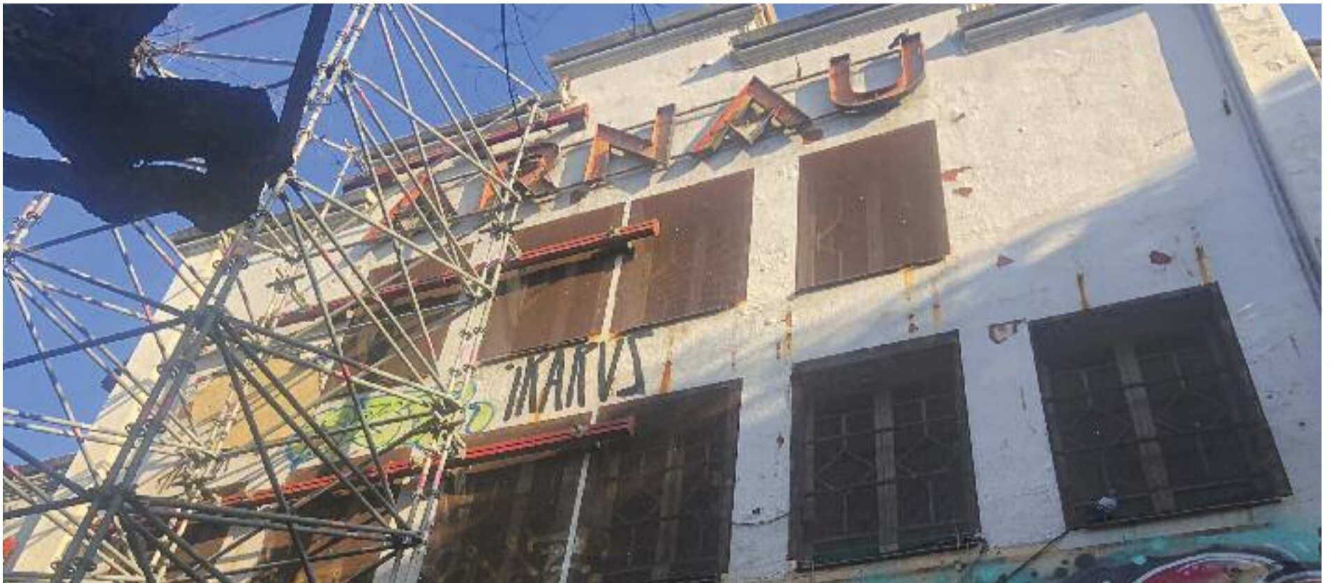
L'edifici està molt deteriorat des de fa temps. Foto: Línia Ciutat Vella
